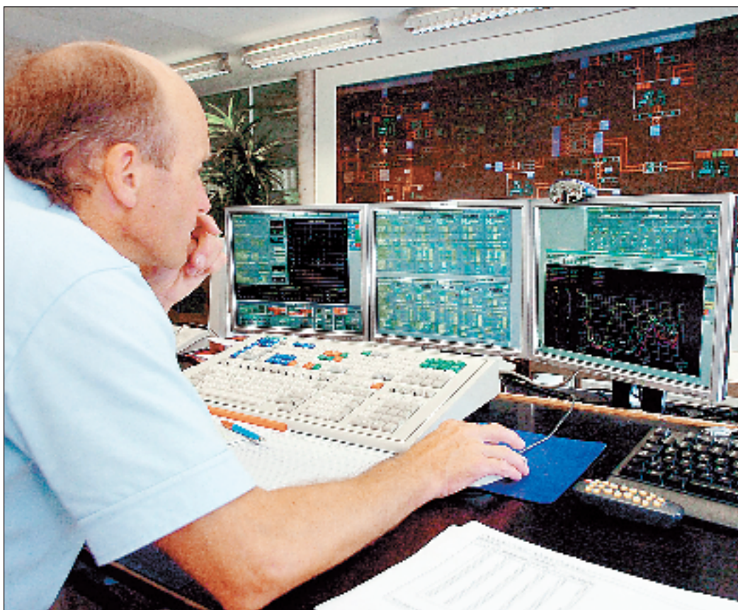
Ein Netzstromüberwacher in der Netzleitzentrale der SBB.
